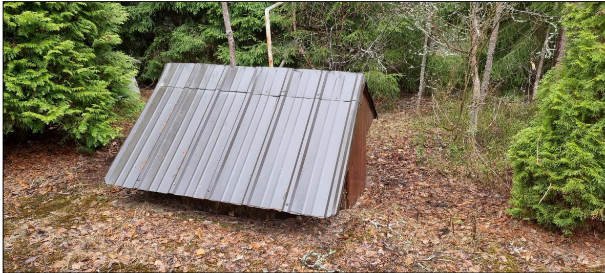
Kuva 1. Kaivo 26, kaivon päällä olevan rakennelman nostamiseen tarvitaan kaksi henkilöä (2.5.2023 / Mitta Oy)
